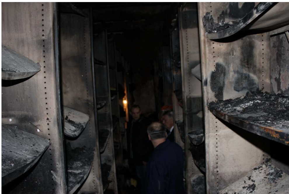
Slika 2: Depo 1 nakon požara
