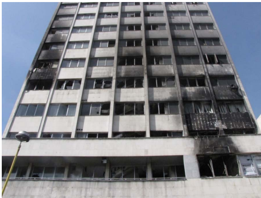
Slika 1: Zapaljena i demolirana zgrada Vlade TK
