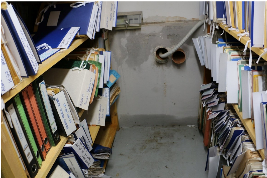
Foto 8: Posledice vdora vode v kletne prostore arhiva MOP
